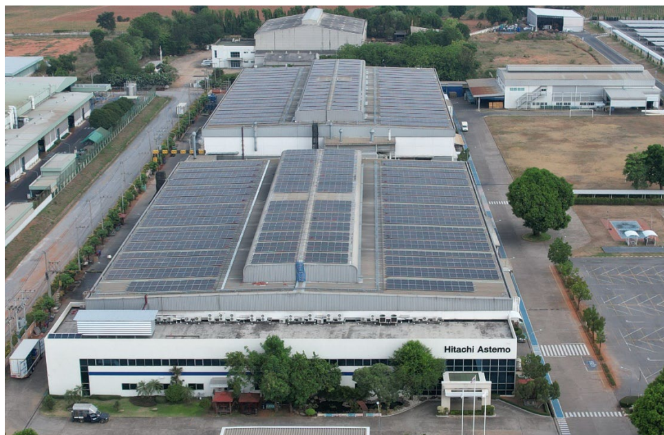
コラート第三工場の屋根に設置される太陽光パネル
