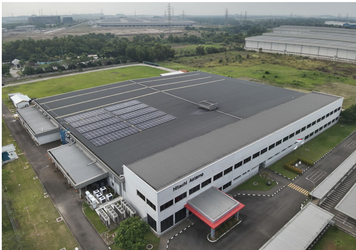
日立 Astemo ブカシブレーキシステムズの屋根に設置した太陽光パネル
